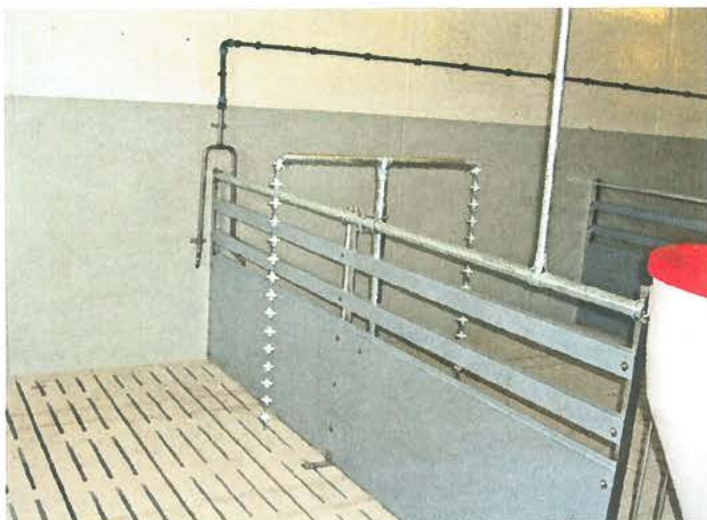
Im Tierbereich sollte für die Wasserleitungen Edelstahl verbaut werden, die „Haltbarkeit“ von Kunststoff wäre hier kurz.
