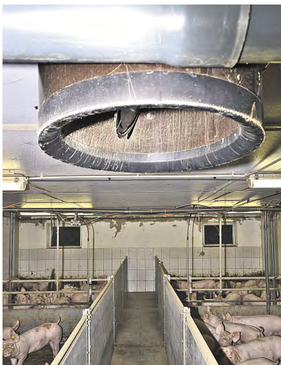
Mit gesteuerten Abluftklappen im Ventilatorschacht lässt sich im Winter viel Heizenergie sparen.
