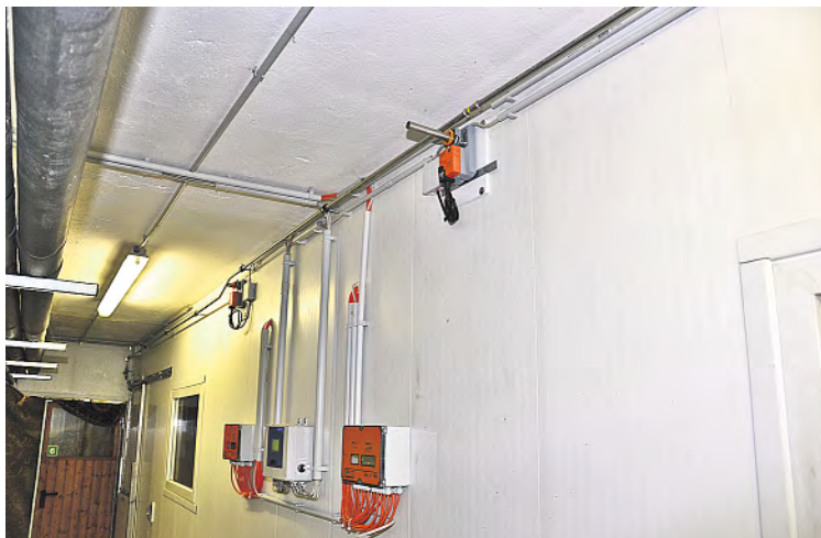
Schön, wenn sich die Stellmotoren im Zentralgang installieren lassen. Dort sind sie besser vor Staub und Feuchtigkeit geschützt. Fotos: Ulrich Averberg
