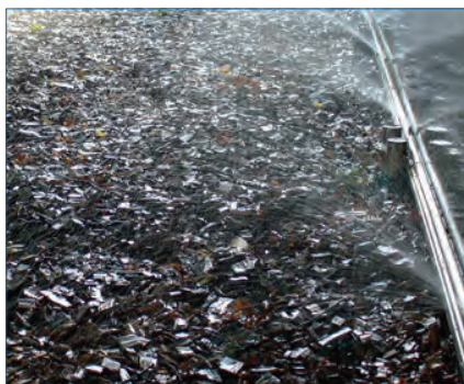
Biofilter mit laufender Berieselung
